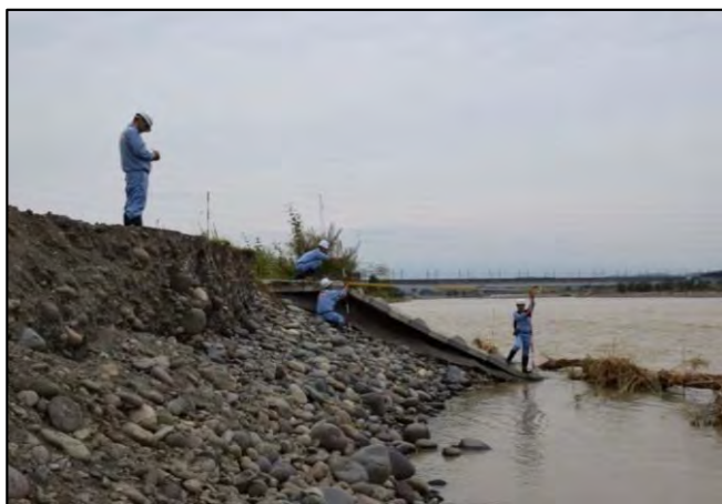
被災状況調査(河川班)
