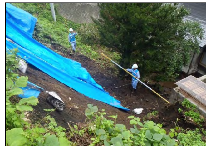
被災状況調査(砂防班)
