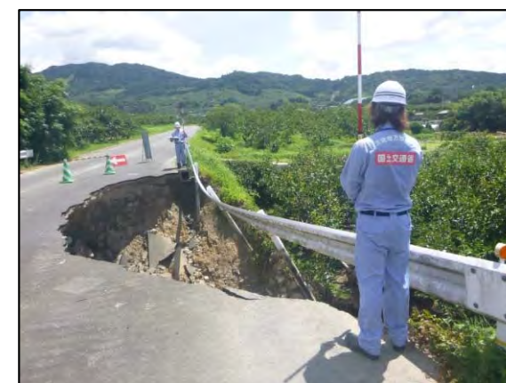
道路被災状況調査(道路班)
