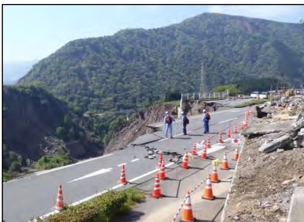
被災状況調査(道路班)
