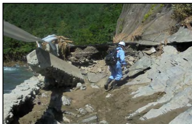
被災状況調査(道路班)
