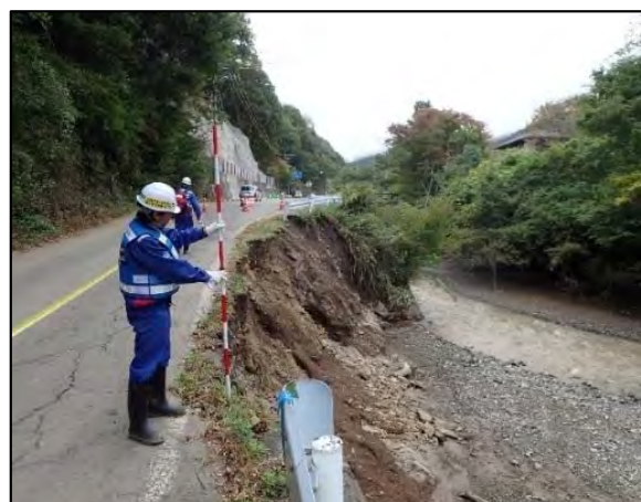
被災状況調査(河川班)
