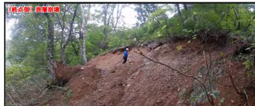
写真-3. 表層崩壊(終点側)
