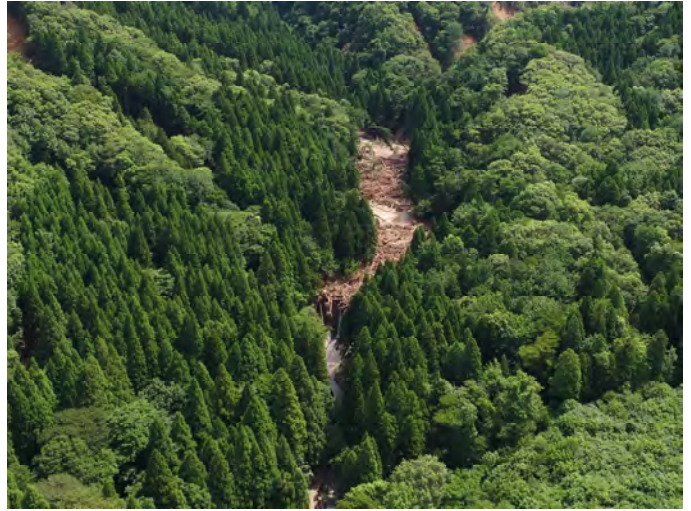
砂防堰堤での捕捉状況
