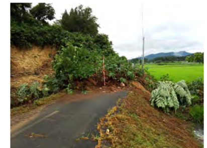
農道の被災（関川村桂）
