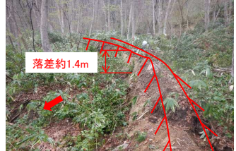
⑤地すべりブロック中段の盛り上がり 二次ブロックの滑動が想定される。
