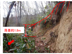
②地すべりブロック頭部滑落崖の状況
