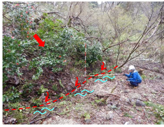
⑥地すべり土塊の押し出し状況
