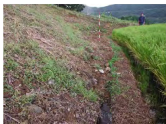
排土工法面崩壊（水路工埋没）
