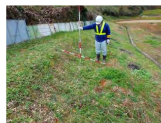
盛土本体の沈下
