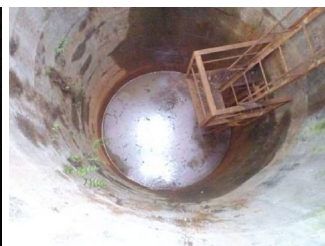
排水管の閉塞
