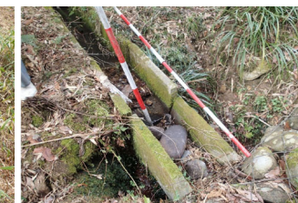
流末水路の破損
