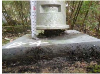
頭部キャップの浮き
