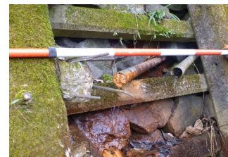
集水管の閉塞
