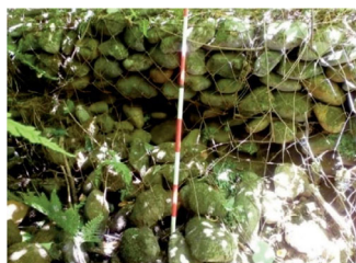
カゴ工の変形
