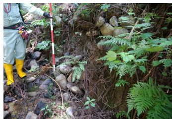
中詰め材の流出
