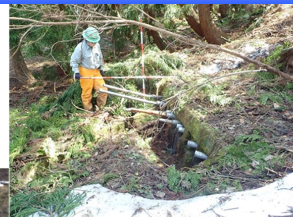
横ボーリング工の被災状況
