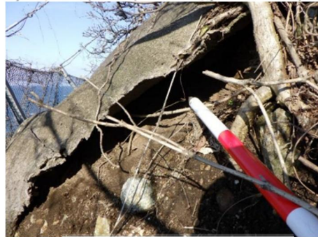
モルタル吹付の空洞
