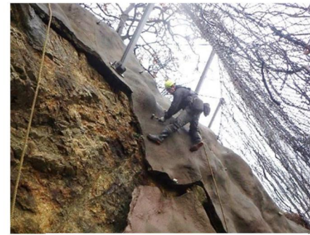
モルタル吹付の亀裂
