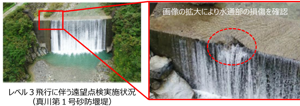
【施設の損傷を確認した事例：立山砂防事務所】
