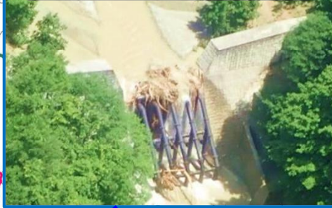
R4.8豪雨の際に流域内で 流木捕捉した砂防堰堤
