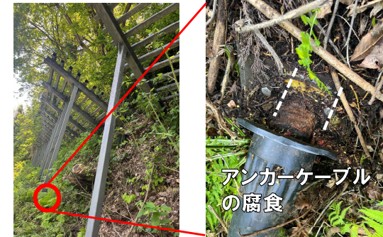
■雪崩予防柵のアンカーの損傷
