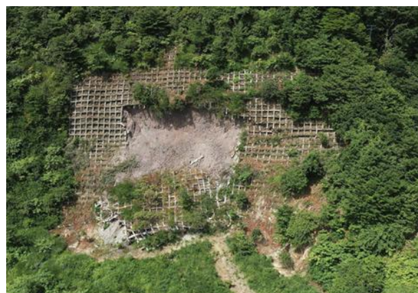
法枠工の被災（佐渡市金井新保・融雪災） 事業名：治山施設災害復旧事業
