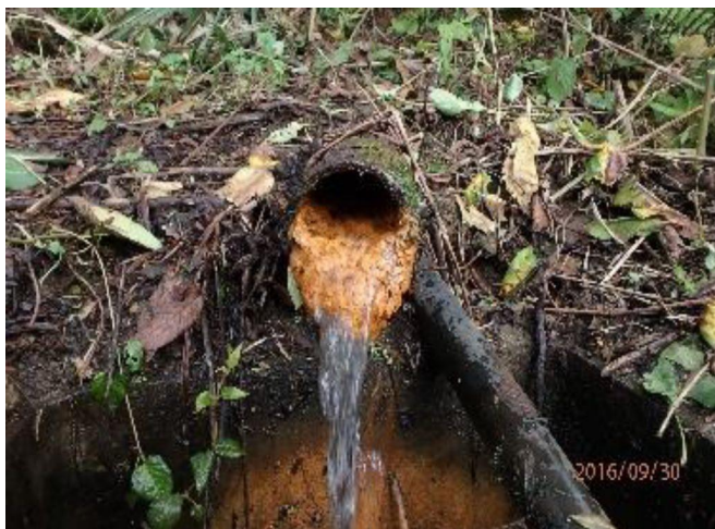
スライムが付着した排水ボーリング孔口
