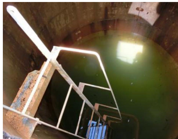
排水不良により湛水した集水井工
